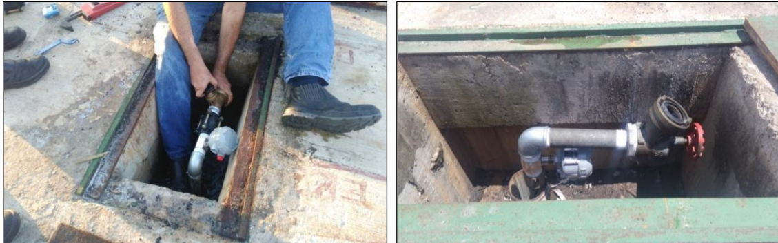
Figura 18. Pontos de abastecimento localizados nos berços de atracação
