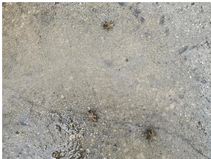
Figura 95 área de lavagem de caminhões. Atração de abelhas, acúmulo de resíduos de açúcar,
