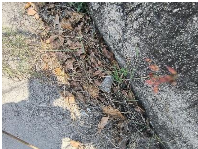
Figura 74 Pátio 1. Copo plástico, reciclável, em local inapropriado. Folhas, falta de limpeza. Não Conformidade.
