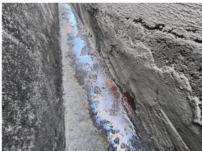
Figura 89 Pátio 2. Drenagem com acúmulo de efluentes. Falta de limpeza e manutenção. Não conformidade.
