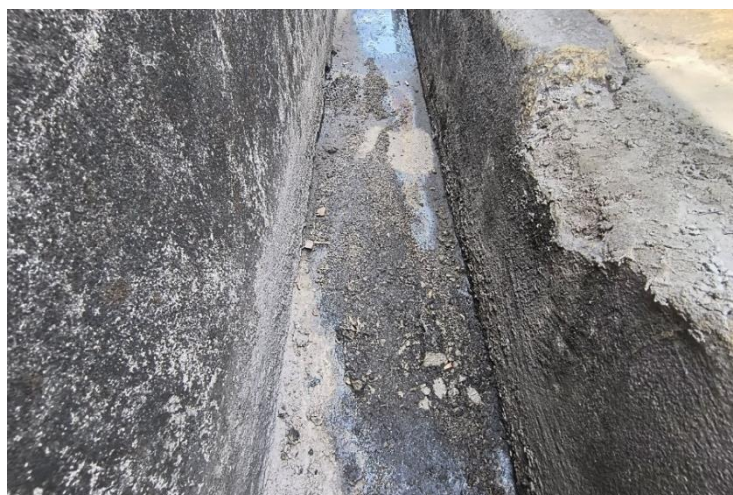
Figura 86 Pátio 2. Drenagem com acúmulo de efluentes. Falta de limpeza e manutenção. Não conformidade.
