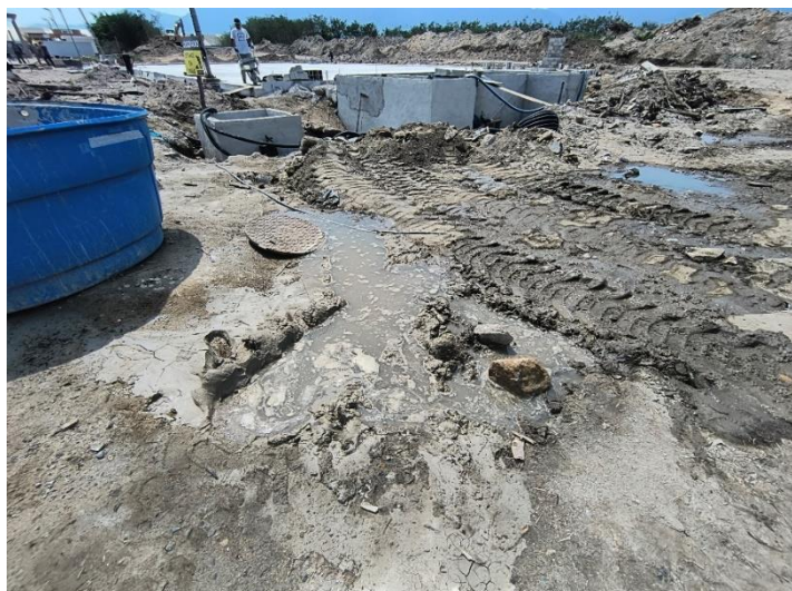
Figura 102 Obras para novo lavador de veículos. Efluentes de betoneira sem contenção, diretamente no solo.
