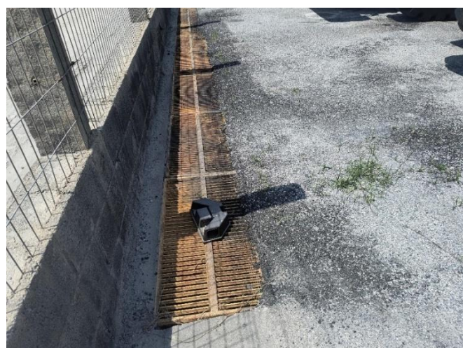
Figura 66 Pátio 3. ratoeira plástica posicionada em local inadequado.
