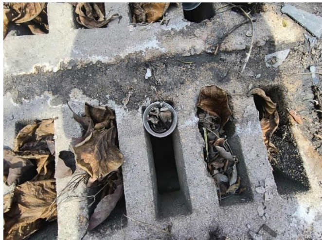
Figura 78 Pátio 1. Copo plástico acumula água parada, tampa de bueiro com obstrução. . Falha na segregação na fonte e cumprimento dos procedimentos operacionais. Não Conformidade.
