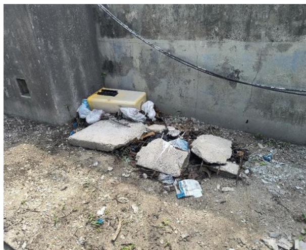
Figura 79 Pátio 1. Resíduos da construção e lixeira quebrada, resíduos misturados no chão, falta de limpeza e manutenção. . Falha na segregação na fonte e cumprimento dos procedimentos operacionais.
