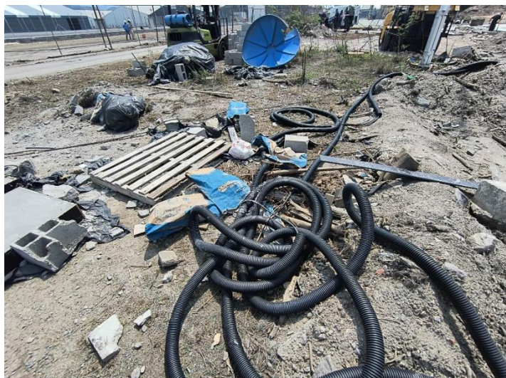
Figura 98 Obras para novo lavador de veículos. Resíduos de construção civil sem segregação na fonte.
