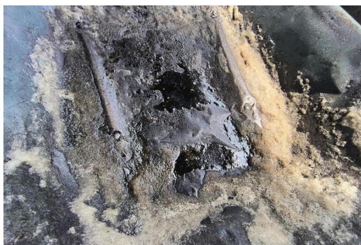
Figura 87 Pátio 2. Drenagem com acúmulo de efluentes. Falta de limpeza e manutenção. Não conformidade.
