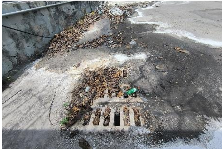
Figura 77: Pátio 1. Tampa de bueiro do tipo grelha com obstrução na drenagem, acúmulo de folhas, resíduos recicláveis, acúmulo de água com resíduos (efluentes). Falha na segregação na fonte e cumprimento dos procedimentos operacionais. Não conformidade.
