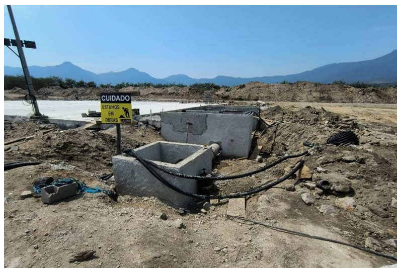
Figura 99 Obras para novo lavador de veículos. Resíduos de construção civil sem segregação na fonte.
