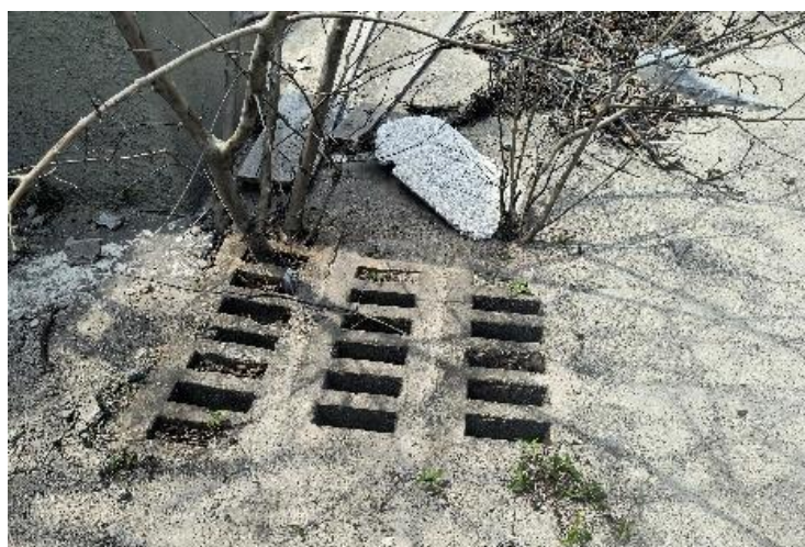
Figura 81 Pátio 1. Árvore nasce no bueiro. Falta de limpeza e manutenção do sistema de drenagem. . Falha na segregação na fonte e cumprimento dos procedimentos operacionais. Não conformidade.
