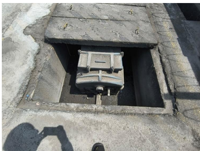
Figura 93 Pátio 2 Caixa Separadora de Água e Óleo SÃO sem limpeza. Não conformidade.
