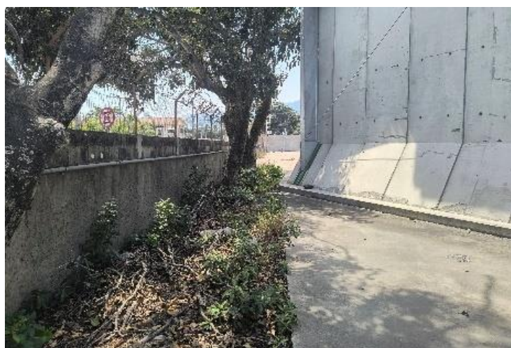
Figura 76 Pátio 1. Canteiro sem jardinagem, manutenção. Falha na segregação na fonte e cumprimento dos procedimentos operacionais. Não conformidade.
