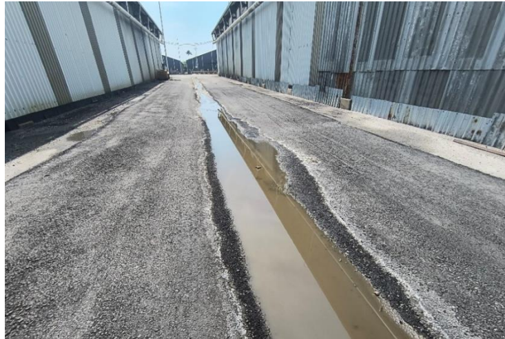
Figura 71 Pátio 3. Acúmulo de água no chão, lavagem de maquinário em local inadequado. Resíduos no chão. Não conformidade.
