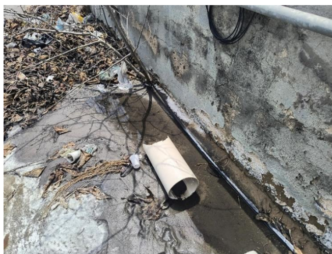
Figura 84 Pátio 1. Acúmulo de água. Acúmulo de folhas. Resíduos recicláveis, pvc, descartados incorretamente. Não Conformidade.
