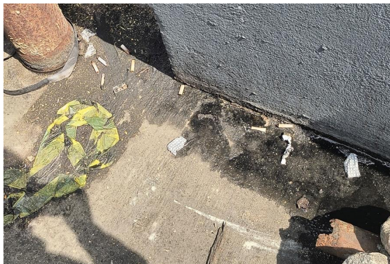
Figura 107 Cais. Bitucas de cigarro e outros pequenos resíduos no piso.
