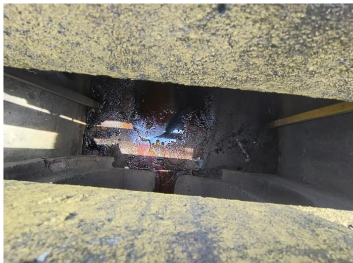
Figura 94 Drenagem de áreas comuns, Via principal. Acúmulo de efluentes. Foi percebida geração de odor.
