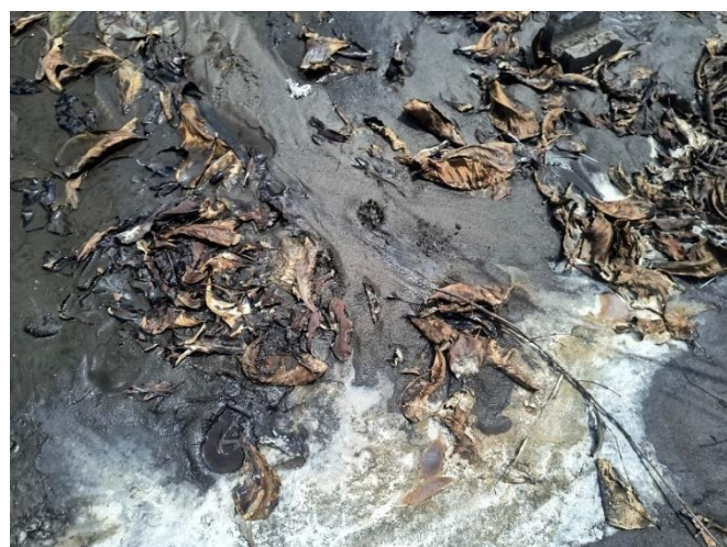
Figura 90 Pátio 2. Drenagem com acúmulo de efluentes. Falta de limpeza e manutenção. Não conformidade.
