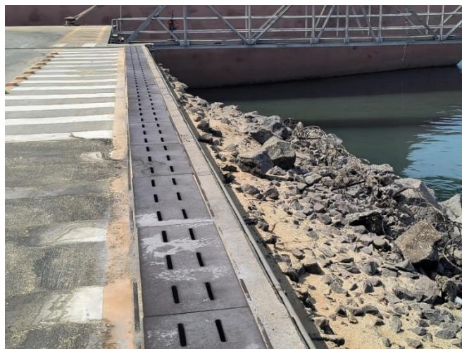
Figura 110 Cais. Deposição de resíduos de cevada no enrocamento.
