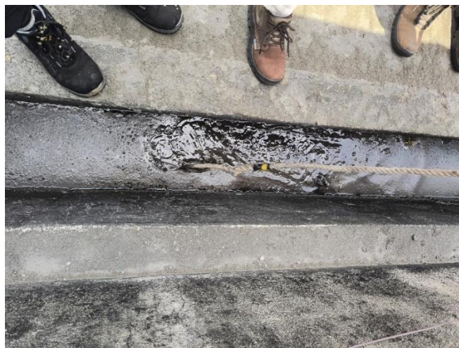
Figura 91 Pátio 2. Drenagem com acúmulo de efluentes. Falta de limpeza e manutenção. Não conformidade.
