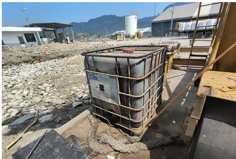
Figura 100 Obras para novo lavador de veículos. Container plástico de combustível sem identificação e sem contenção.
