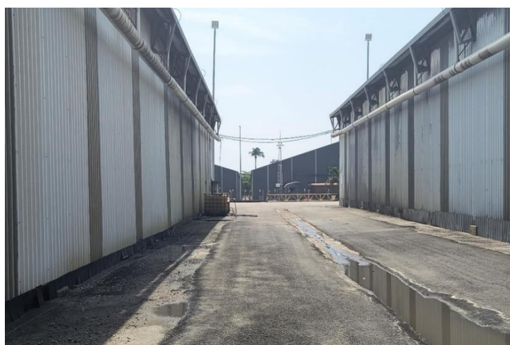
Figura 69 Pátio 3. Acúmulo de água no chão, lavagem de maquinário em local inadequado. Resíduos no chão. Não conformidade.
