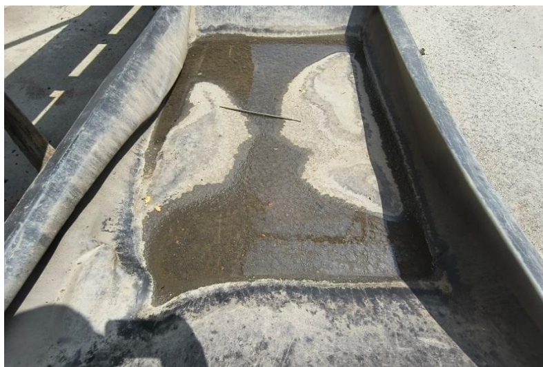
Figura 97 Obras para novo lavador de veículos. Caixa plástica de contenção com acumulo de água e sujeira.
