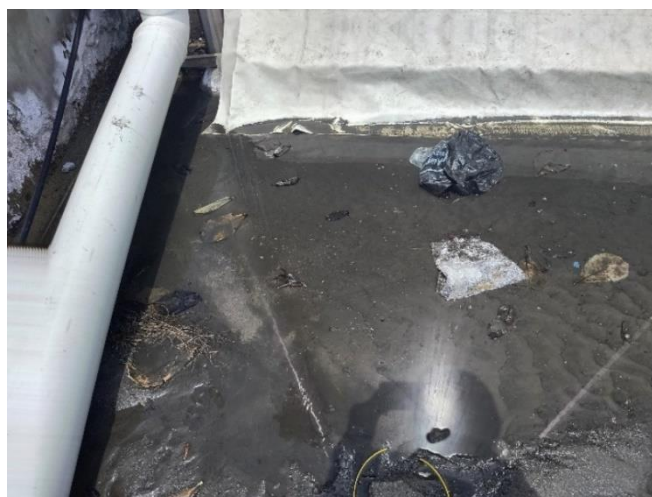
Figura 83 Pátio 1. Acúmulo de água. Não Conformidade.
