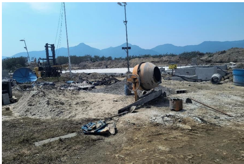
Figura 101 Obras para novo lavador de veículos. Efluentes de betoneira sem contenção, diretamente no solo.
