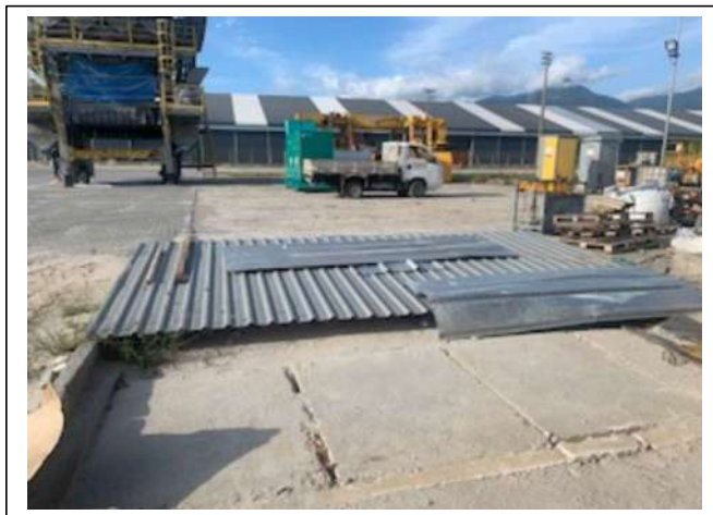
Caixa Separadora de Água e Óleo (SÃO) – Manutenção
